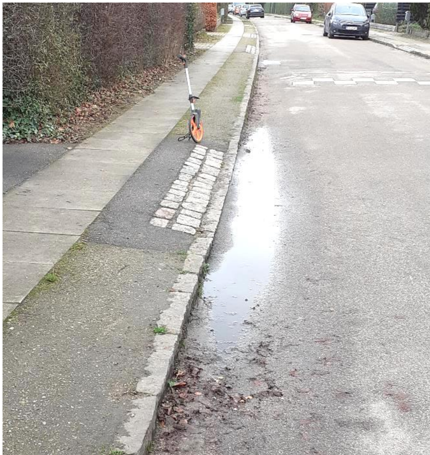
Foto 3.2.2.1: Indkørsel med lunke/sætning på Kjærstrupvej.
