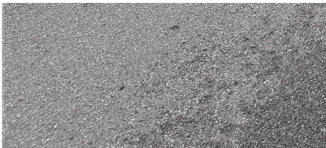
Foto 3.7.0.1: Overflade på gammelt slidlag, der ses mørtel og stentab.
