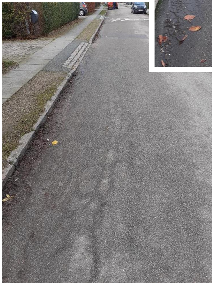
Foto 3.3.4: Revner i vejbanen, vestlig vejside. Der ses mange revner i den vestlige side af Kjærstrupvej på det lange lige stykke. Bør udskiftes.
