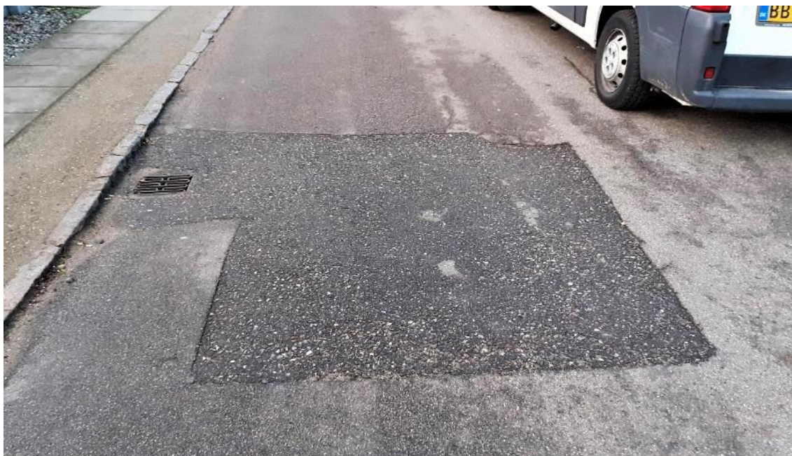
Foto 3.2.1.1: Felt hvor belægning er udskiftet, i forbindelse med ledningsarbejde. Skal have slidlag, efter fræsning og klæbning.
