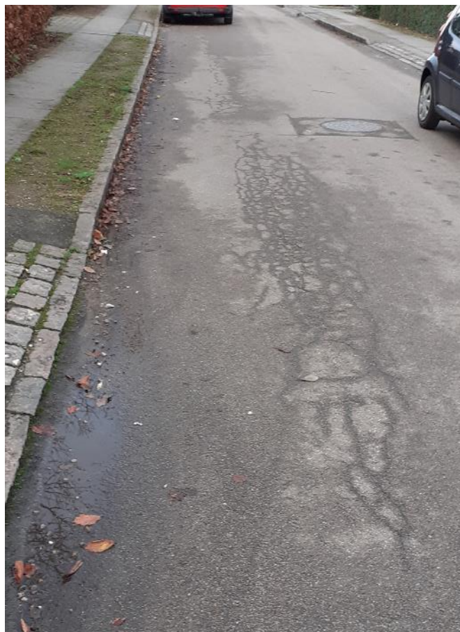
Foto 3.3.3: Tæt revnemønster i vestlig side af vejbanen, Kjærstrupvej. Bør udskiftes.
