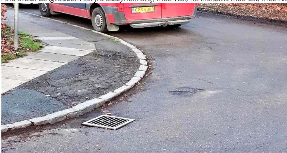
Foto 3.6.2: Langvaddam, hjørne mod Ålstrupvej. Der er ikke megen plads her. Fortov bliver brugt, når lastvogne skal rundt. Revner i det meste af området her.
