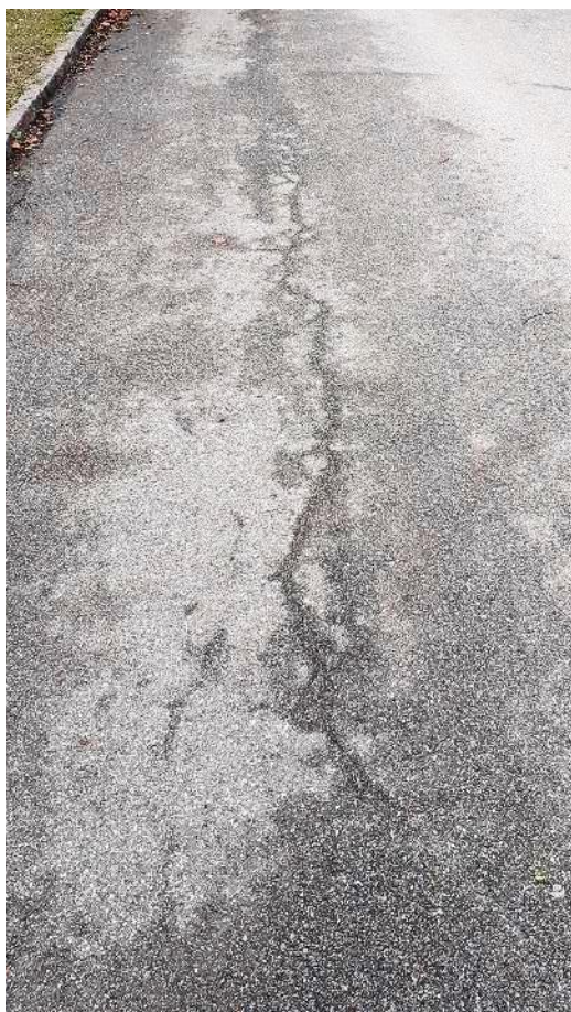
Foto 3.2.3.2: Større (langsgående) revne
