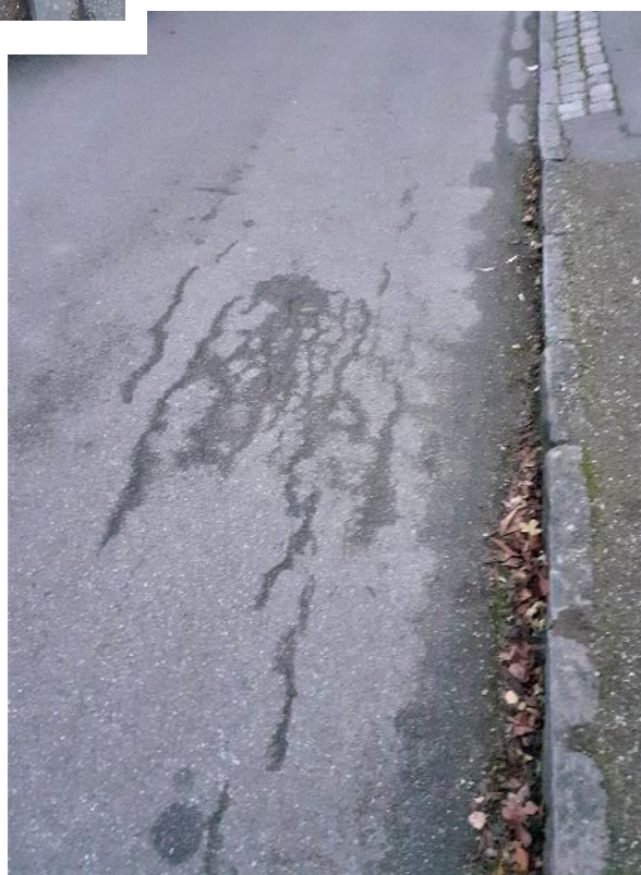
Foto 3.4.4: Plet med mange revner, vestlig side af vejbane. Bør udskiftes. For både Sæbyholmsvej og Kjærstrupvej lange lige nord/syd gående stræk, er det karakteri- stisk med en del revner, mere eller mindre, - i den venstre, vestlige side.
