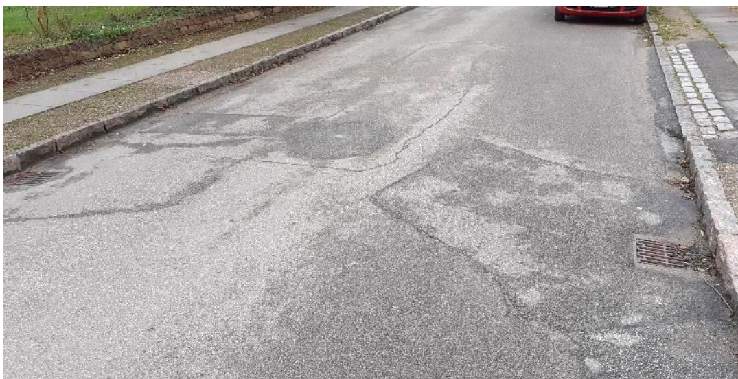
Foto 3.2.3.1: Revner omkring felter, hvor der har været ledningsarbejder.
